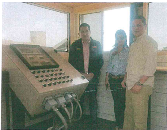
Imagen 4: Área de control de planta
