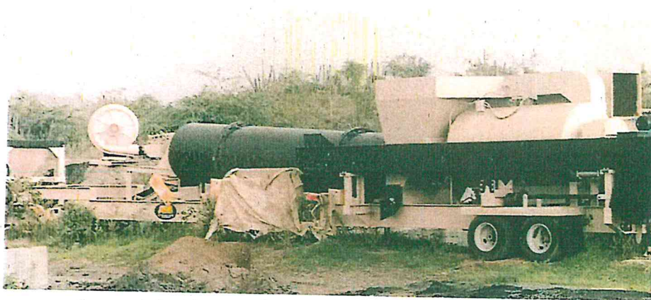
Imagen 1. Instalaciones planta DESARROLLO VIAL PLANTA II.
