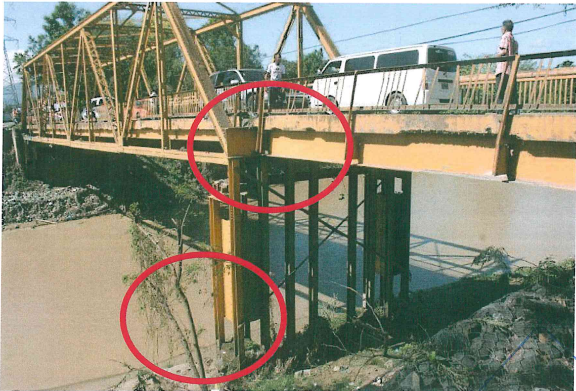
Foto del Puente existente Sobre Río Camú, ubicado en la comunidad de Sabaneta, se observa un sustancial menoscabo en sus características físicas y el congestionamiento que genera su reducido ancho de calzada de 5.80 m.
