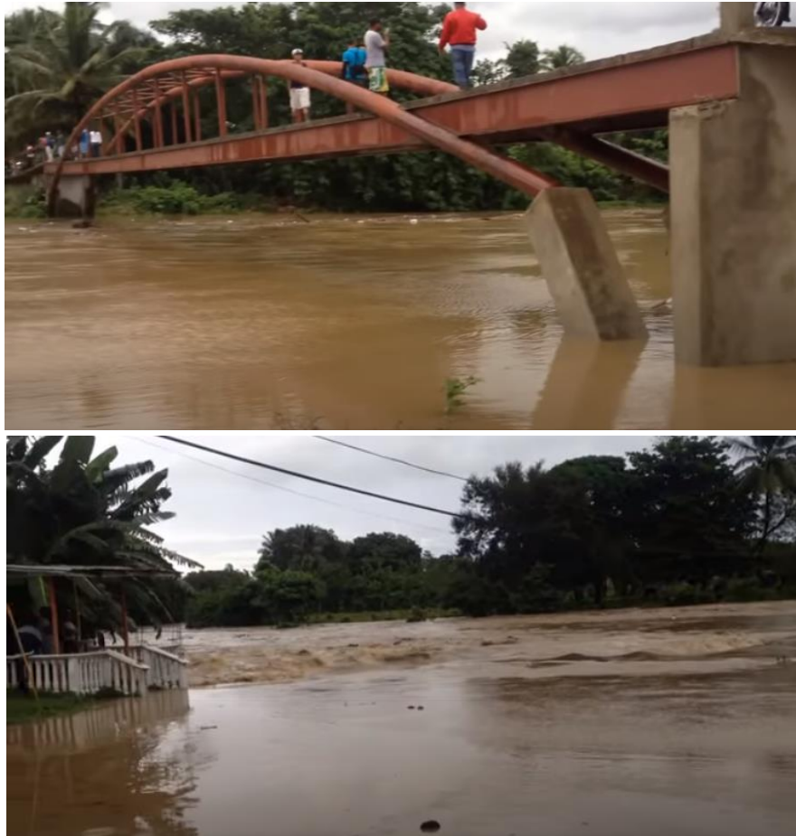
Ilustración 3. Puente Peatonal existente y crecida del río Veragua.
