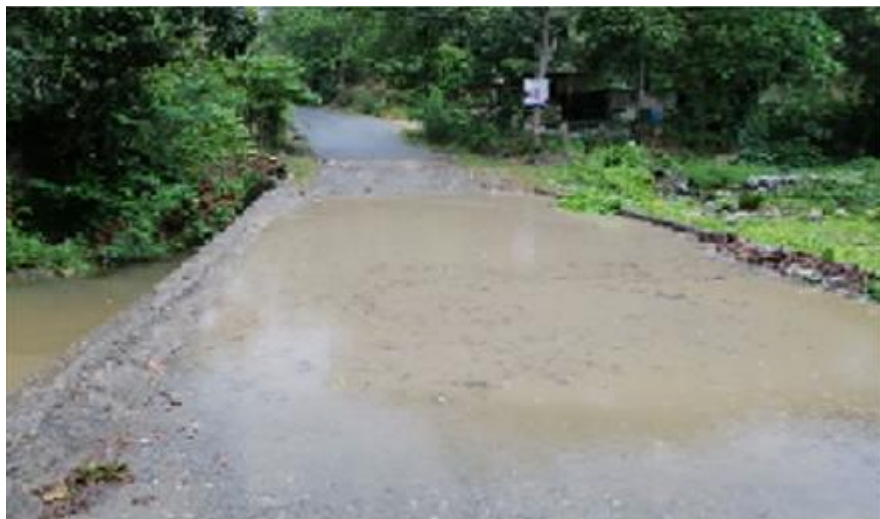
Ilustración 8: Inundación que afecta el tránsito en el puente No. 1 por una lluvia de mediana intensidad
