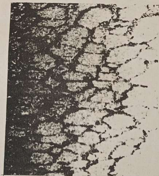
Fig. Núm. 1 - Grietas de Cocodrilo.
