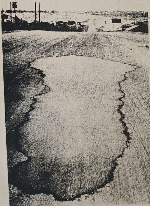
Fig. Núm. 50 - Depresión (Area Deprimida se denota por el Agua en el Pavimento).
